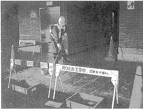
防滑工事の施工風景。タイルなどの床材を滑りにくくしている
